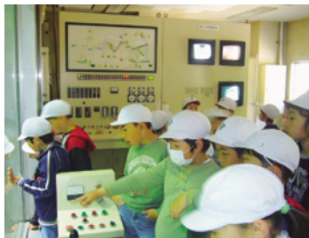
▲清掃センター粗大操作室内
